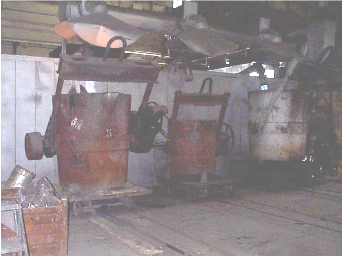
Fig. 3.11.4 Impianto di trattamento termico del refrattario delle siviere , dotato di aspirazione localizzata e di carrelli per la movimentazione: il carroponte deposita la siviera sul carrello che poi viene fatto scorrere su un binario fino a sotto l'impianto.
