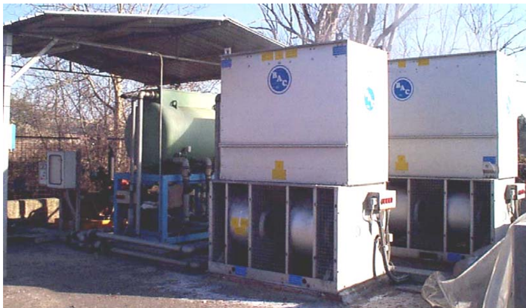
Fig. 3.9.12 Impianto di addolcimento e raffreddamento dell'acqua utilizzata per il raffreddamento dei forni.
