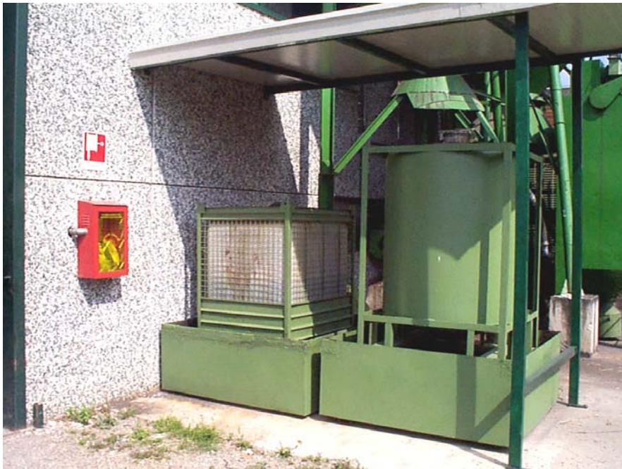
Fig. 3.2.13 Stoccaggio esterno di resina e induritore con bacini di contenimento separati.
