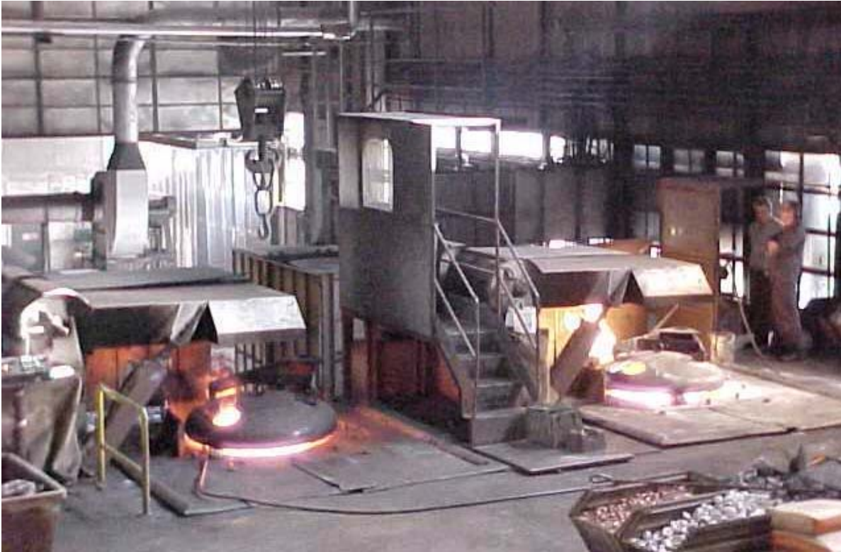
Fig. 3.9.9 Forni elettrici ad induzione visti da sopra dotati di cappe mobili di aspirazione e postazione di controllo schermata (i quadri di comando di tutto l'impianto si trovano in una cabina insonorizzata a lato della piattaforma). Il forno di destra è pieno di lega metallica fusa pronta per essere spillata (Fig. 3.9.23 A/B/C), mentre il forno di sinistra è al momento inattivo e si nota che in esso è inserita la fiaccola accesa per mantenere caldo il refrattario (si vede bene la fiaccola appoggiata sotto il coperchio e il tubo flessibile, disteso lungo la piattaforma, di collegamento all'impianto del gas metano).
