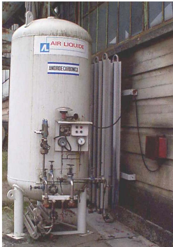
Fig. 3.5.1 Serbatoio esterno dell'anidride carbonica.
