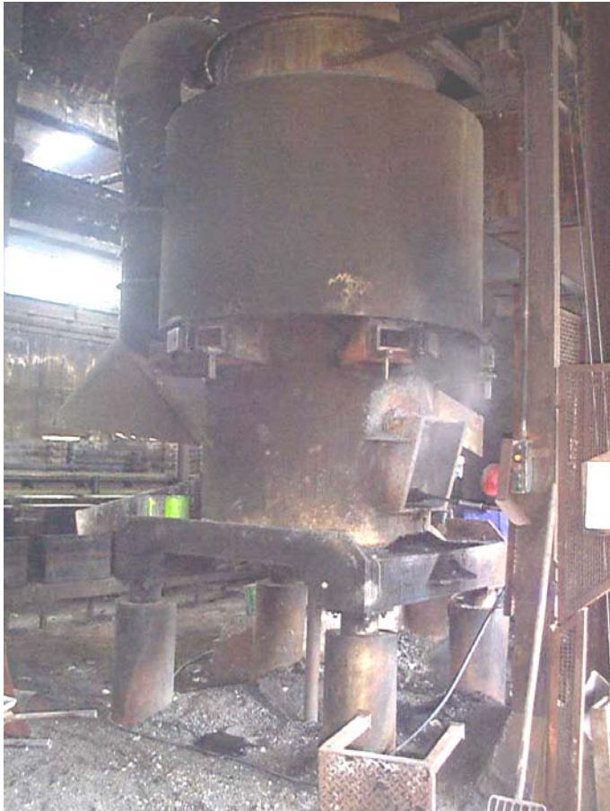
Fig. 3.9.14 Particolare del retro di un forno a cubilotta in pausa.
