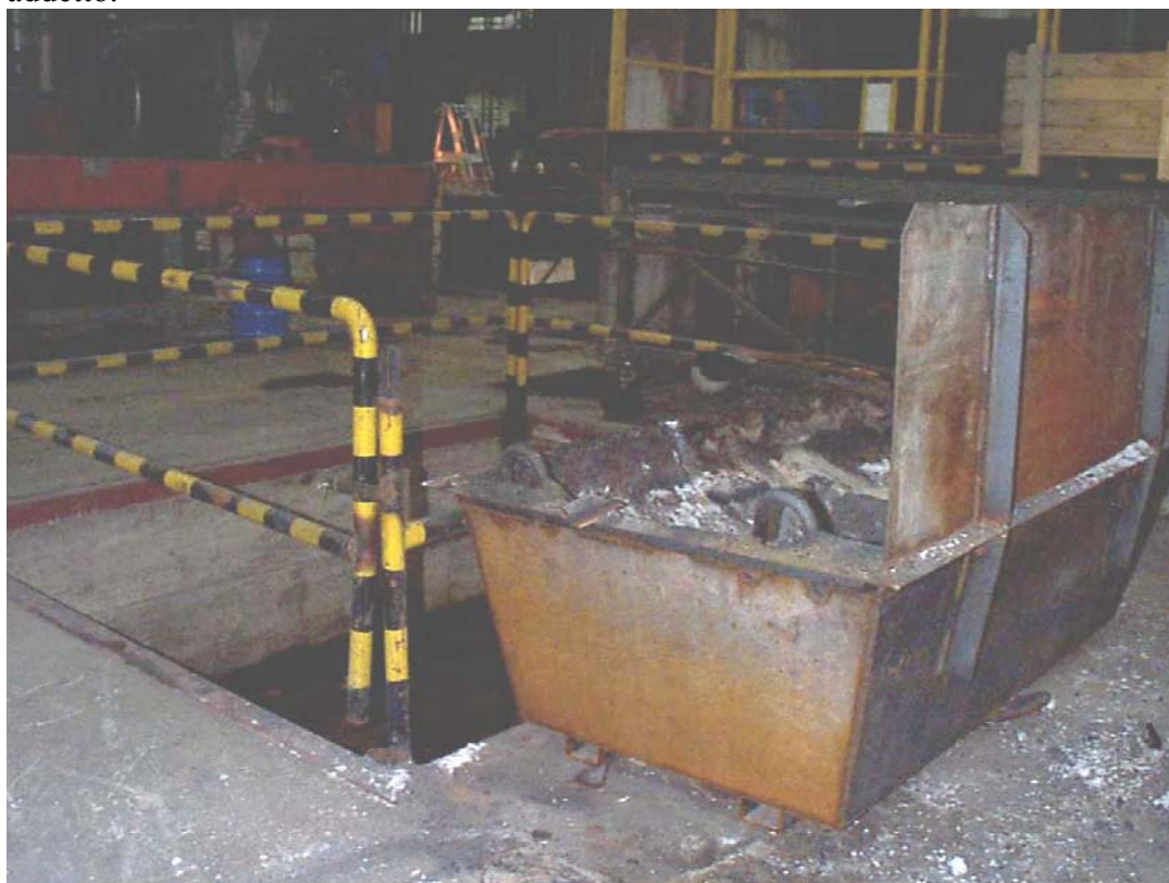
Fig. 3.10.5 Postazione di scorificazione per siviere di grandi dimensioni, con fossa, schermo e parapetti.
