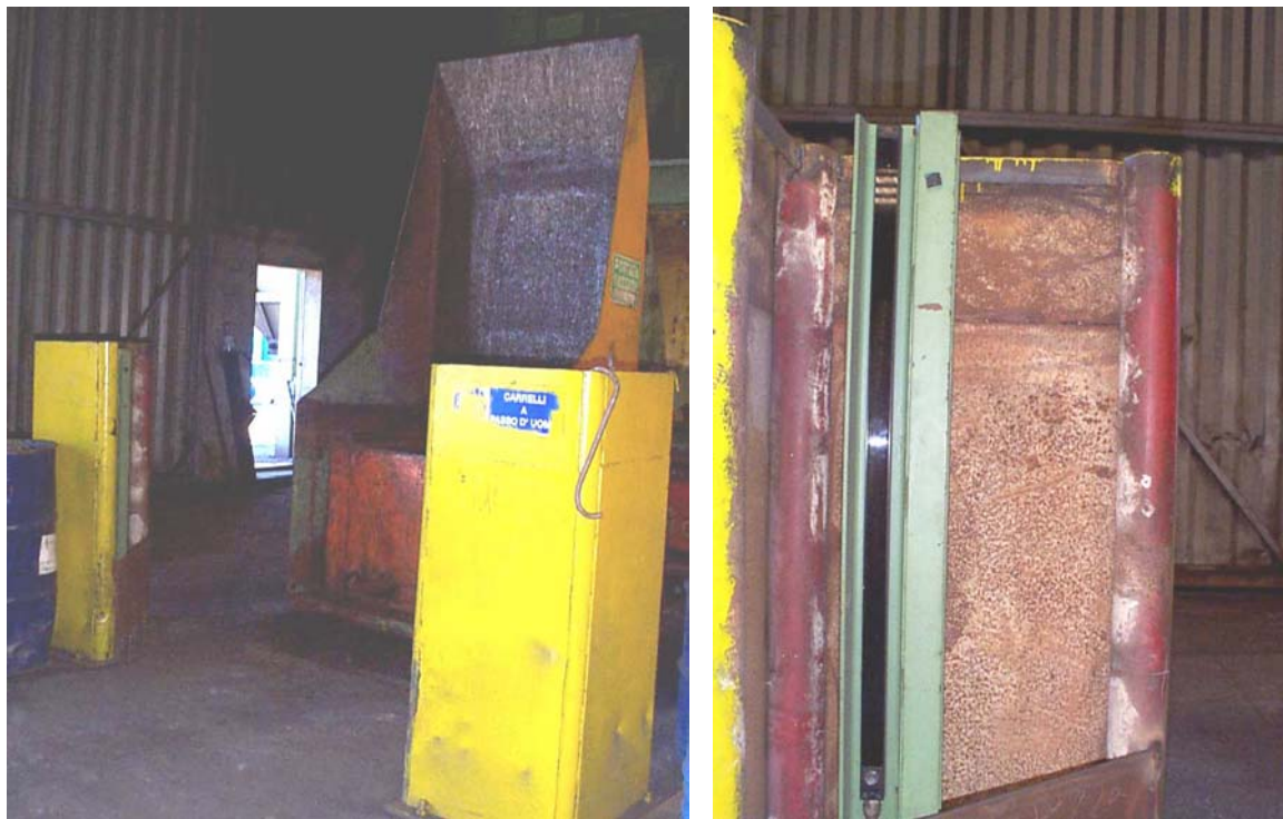
Fig. 3.13.3 A/B: sistema di protezione con fotocellule al caricatore automatico della sabbiatrice a tappeto. A: vista d'insieme; B: particolare della barra di fotocellule.
