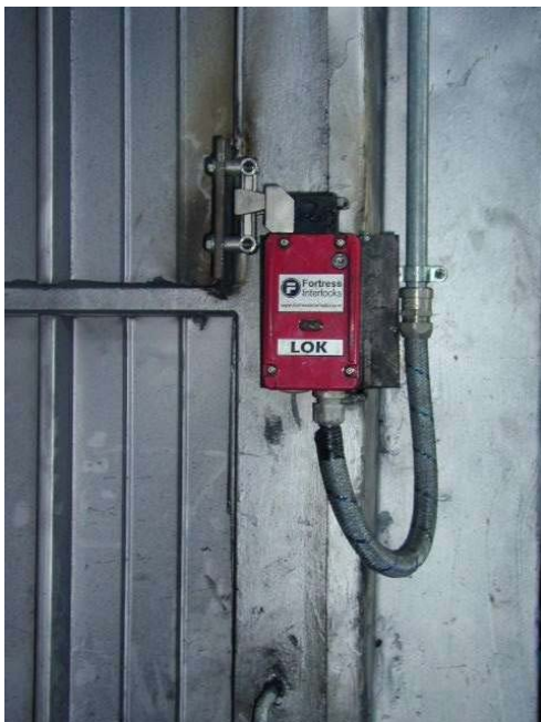
Uno dei quattro dispositivi di interblocco con bloccaggio del riparo, installati sulle porte delle segregazione dei carri
