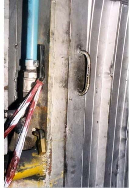
chiusura di "sicurezza" per le segregazioni delle aree operative dei carri introduttori ed estrattori
