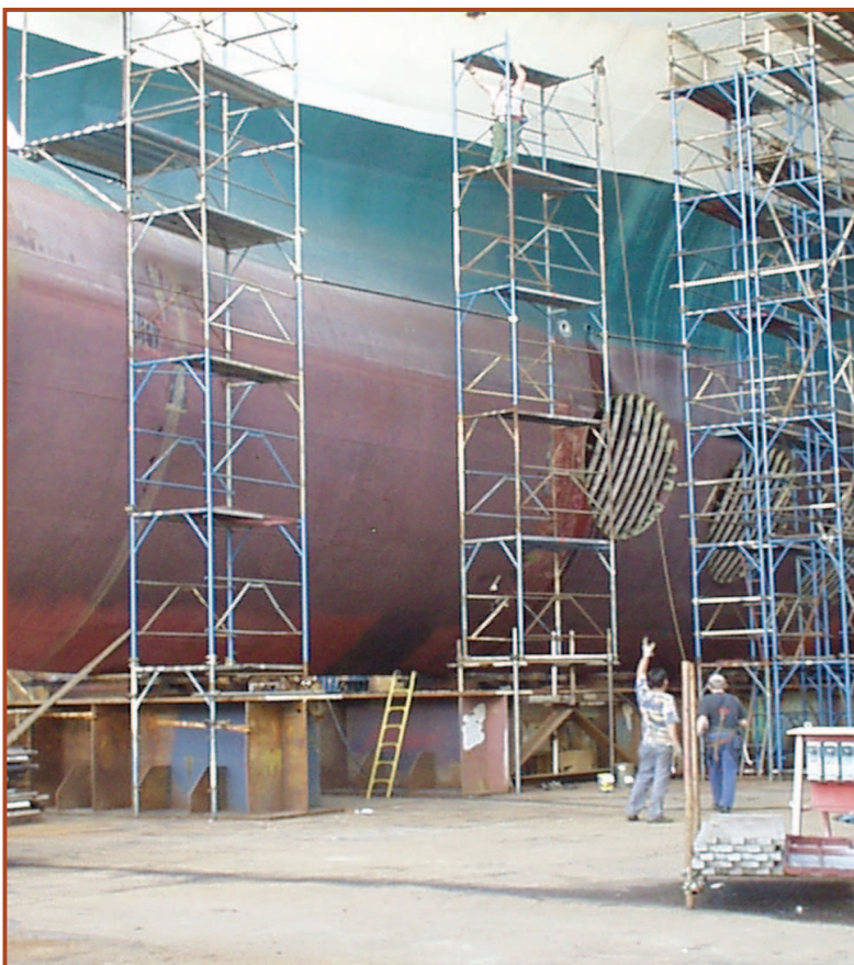
Foto 17 Il castello ripreso nella foto è sprovvisto di scale idonee a garantire l'accesso agli impalcati superiori in sicurezza.
