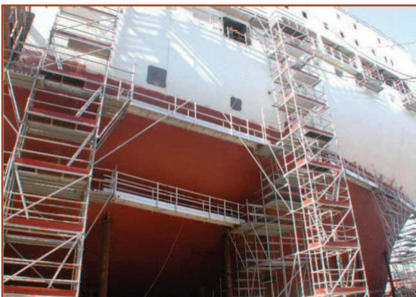
Foto 16 Verificare periodicamente il buono stato di conservazione degli elementi vista anche la particolarità degli ambienti dove sono collocate le
