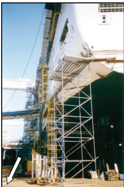
Foto n.14 Area di lavoro. La freccia bianca indica la zona di stoccaggio temporaneo degli elementi del ponteggio
