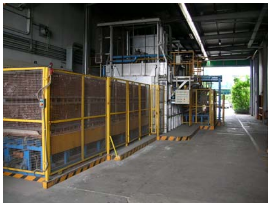
Figura 3.10.1. Trattamenti termici. Forno a metano: il sistema di caricamento è completamente segregato
