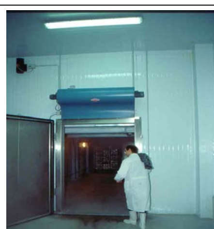
Fig. 43: cella con barriera d'aria all'ingresso
