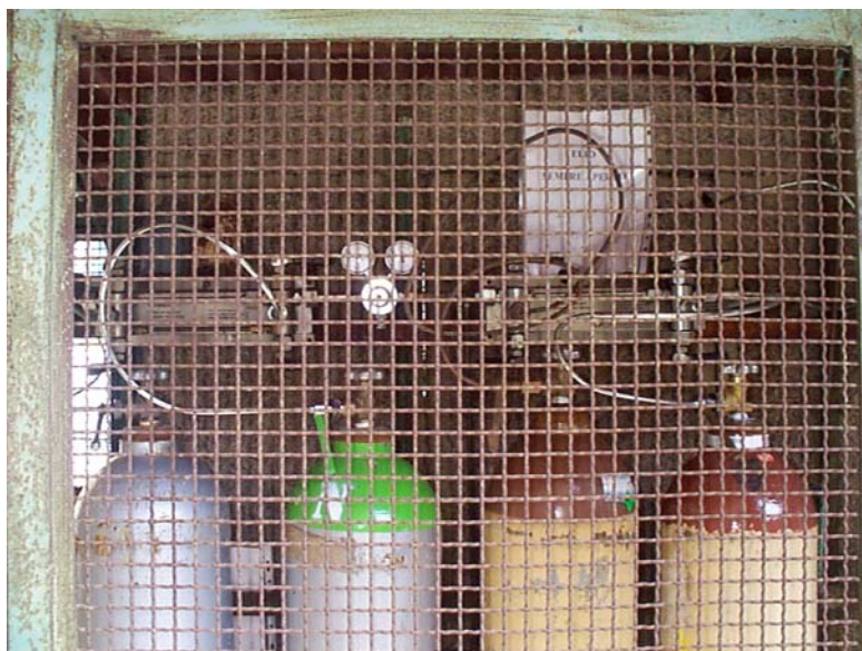
17 Foto 0.1 Stoccaggio esterno di gas tecnici, in evidenza le valvole di connessione delle bombole all'impianto di erogazione centralizzato.
