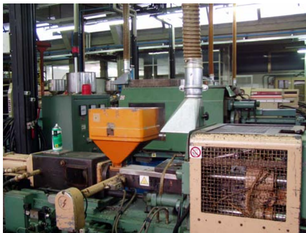
Foto 13 – cappe aspiranti per presse ad iniezione
