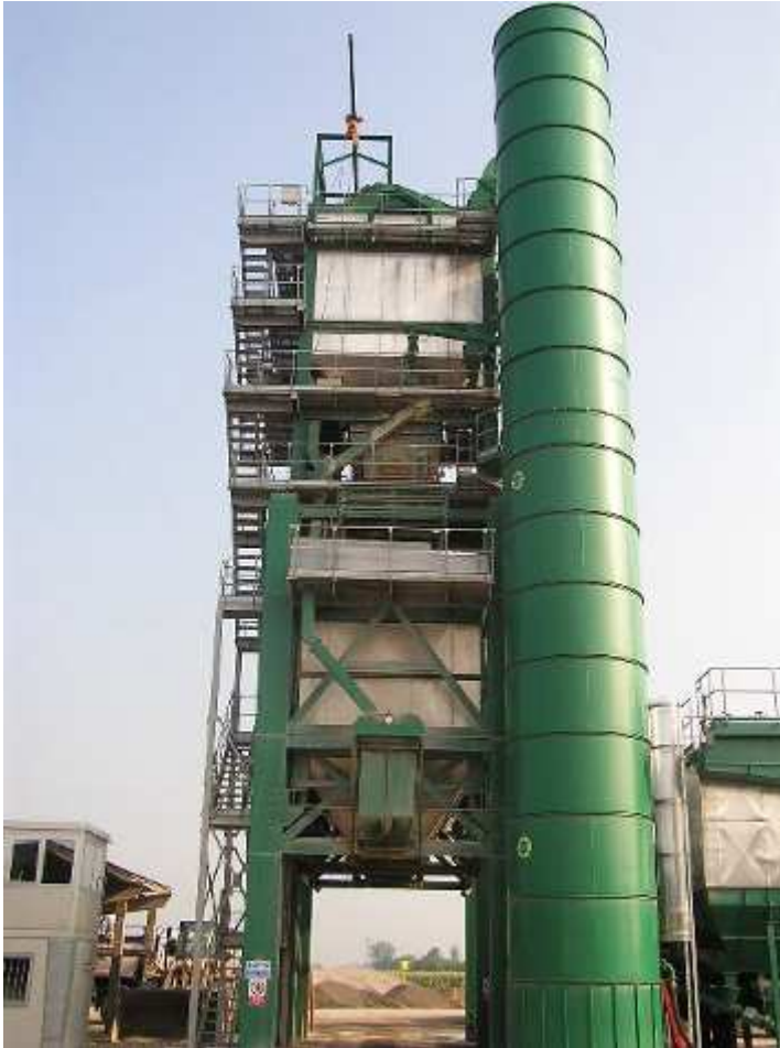
Figura 2-9 –Torre di miscelazione.
