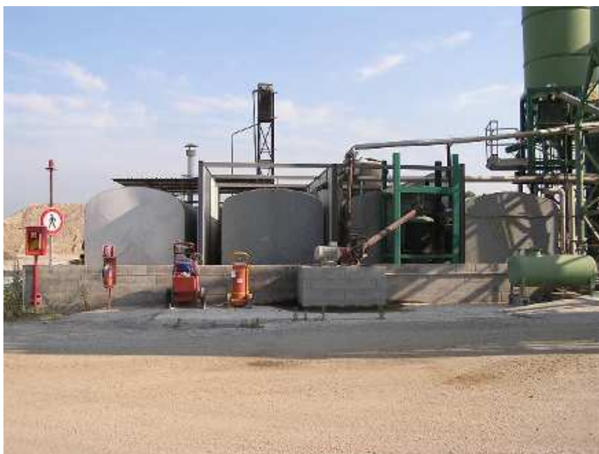
Figura 2-4 – Stoccaggio bitume nello stabilimento di produzione.
