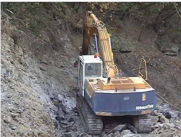
Fig. 18 L'allontanamento degli strati superficiali di arenaria e galestro mediante escavatore attrezzato con martellone.
