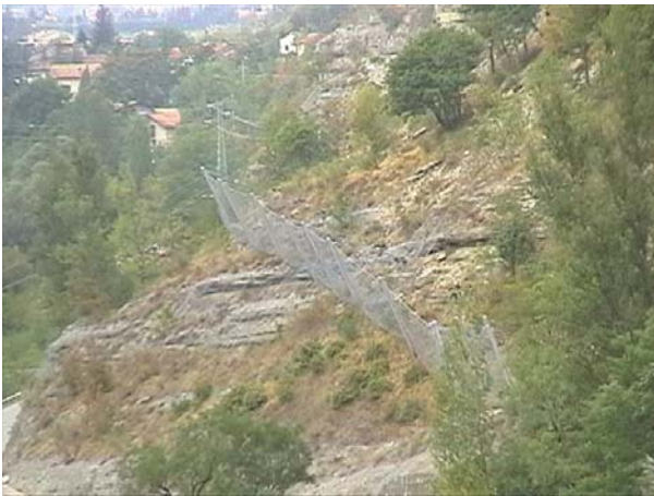
Fig. 32 Reti paramassi stradali
