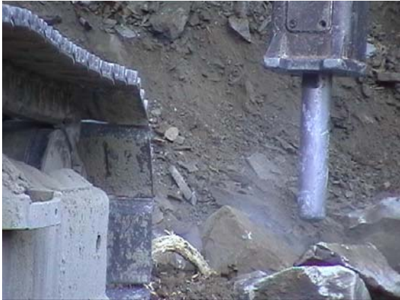
Fig. 21 L'allontanamento degli strati superficiali di arenaria e galestro mediante escavatore attrezzato con martellone (particolare).
