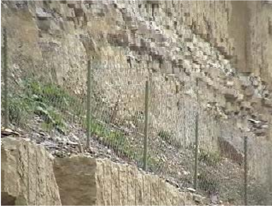
Fig. 55 Protezione del piazzale di cava contro la caduta di materiali dall'alto, mediante rete
