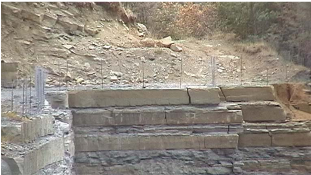
Fig. 56 Protezione del piazzale di cava contro la caduta di materiali dall'alto, mediante rete
