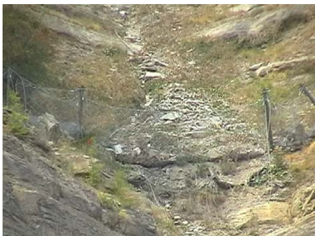
Fig. 30 Reti paramassi di cava
