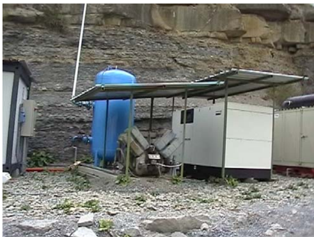
Fig. 57 Impianto compressori per la produzione dell'aria compressa dei quali uno insonorizzato con relativo deposito
