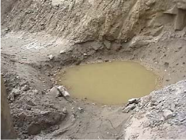
Fig. 49 Vasca di decantazione e fosso di raccolta e di guardia delle acque meteoriche
