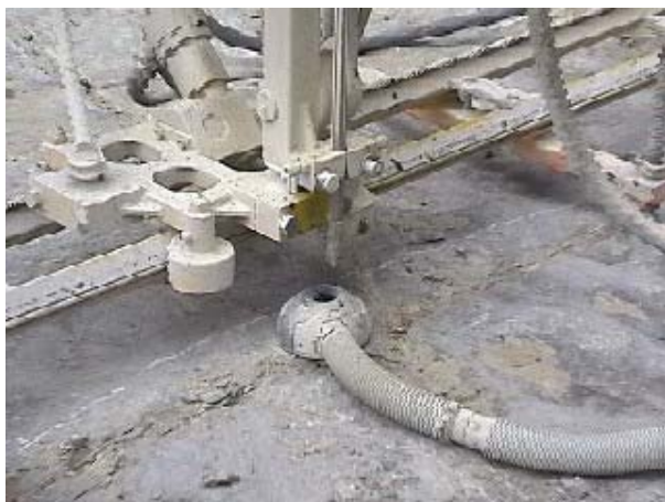
Fig. 09 Sistema di aspirazione localizzato su tagliablocchi
