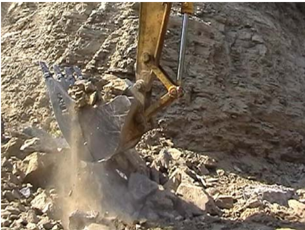
Fig. 38 Allontanamento con escavatore degli strati superficiali di arenaria e galestro dopo disgregazione mediante martellone
