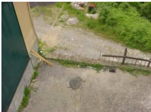
Foto n. 15 - luogo di transito del personale sprovvisto di parapetto contro la caduta nel vuoto.
