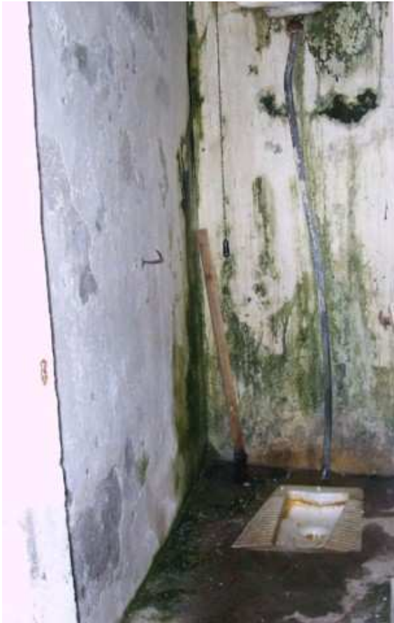
Foto n. 26 - gabinetto alla turca in condizioni pessime di igiene.
