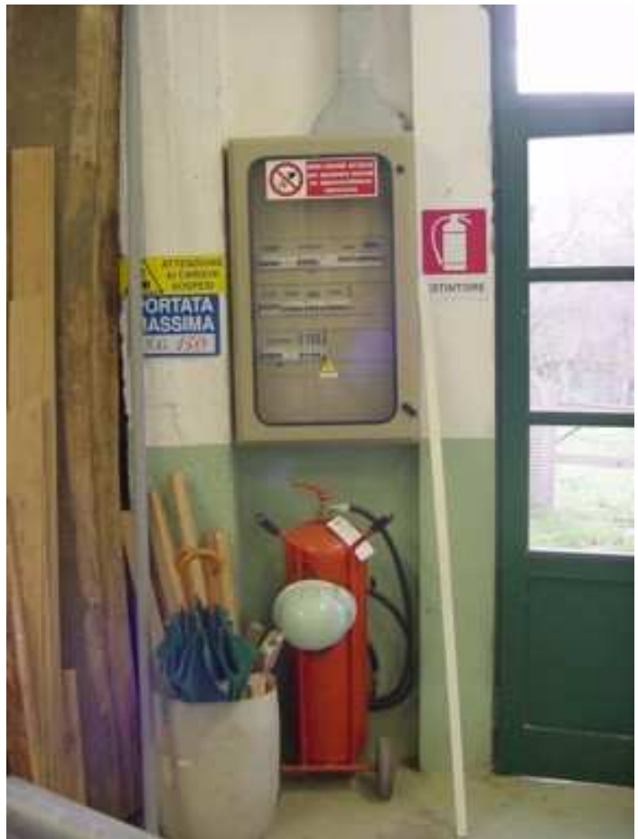
Foto n. 25- quadro elettrico regolare. Tutti i componenti sono conformi alle Norme C.E.I., non ci sono elementi sotto tensione accessibili, sopra ad ogni interruttore automatico ci sono le indicazioni dei circuiti protetti, è dotato di interruttore generale differenziale, di messa a terra, di pulsante all'esterno per lo sgancio rapido dell'interruttore generale in caso d'incendio. Il tutto certificato da tecnico abilitato secondo quanto previsto dalla Legge 46/90.
