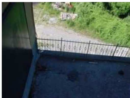
Foto n. 16 - stesso luogo della foto n. 15 successivamente dotato di parapetto.
