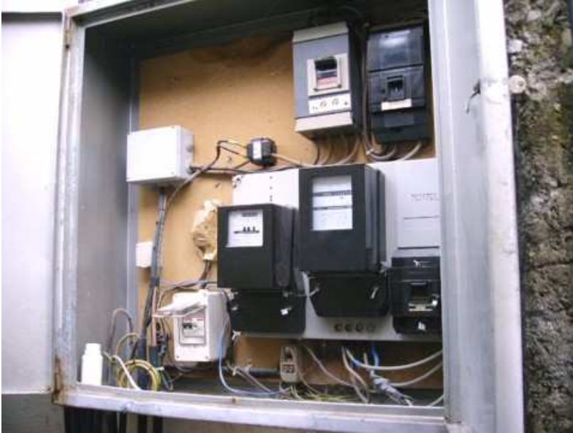
Foto n. 24 - quadro elettrico generale ricavato nell'armadio del contatore Enel. Tale quadro risulta sprovvisto delle indicazioni di riferimento dei 4 interruttori, presenta possibilità di contatto diretto con alcuni elementi nudi in tensione, è assemblato con alcuni componenti (armadio, cavi tipo piattina ecc.) non conformi alle Norme di buona tecnica tecnica (es. Norme C.E.I), ed inoltre non presenta nessuna garanzia sulla protezione dai contatti diretti ed indiretti dei circuiti alimentati (soprattutto anche per la mancanza di interruttore differenziale generale).
