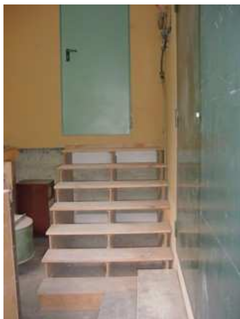
Foto n. 17 - scala di accesso ad un magazzino sprovvista di corrimano-parapetto.
