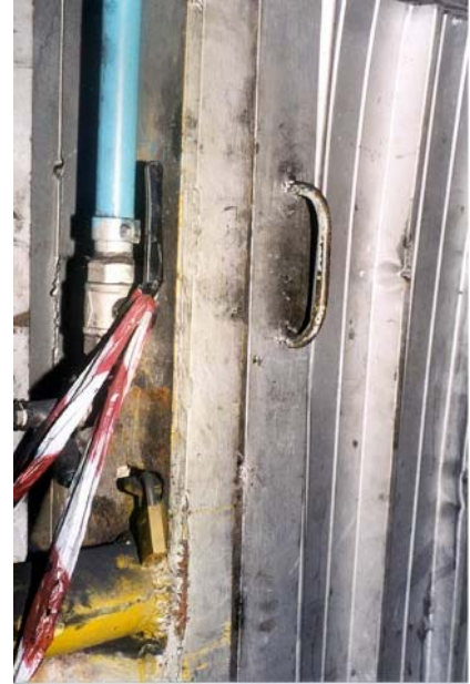
chiusura di "sicurezza" per le segregazioni delle aree operative dei carri introduttori ed estrattori
