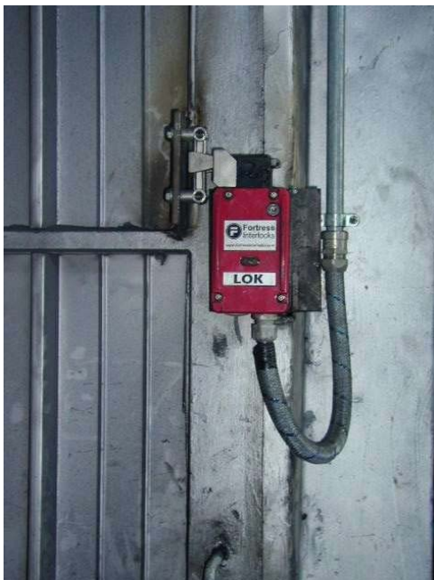
Uno dei quattro dispositivi di interblocco con bloccaggio del riparo, installati sulle porte delle segregazione dei carri
