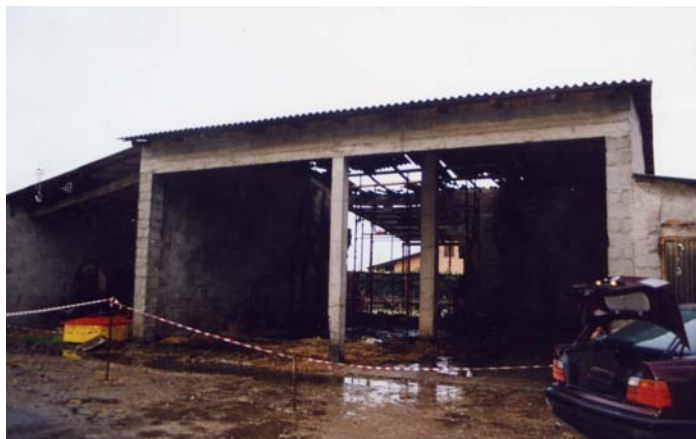
Copertura costituita da lastre in cemento-amianto danneggiata da un incendio
